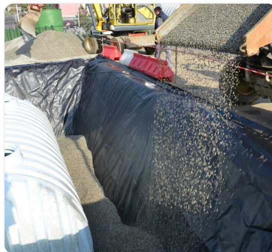
Aterro por camadas sobre o reservatório RoDrive, sem laje de alívio.
